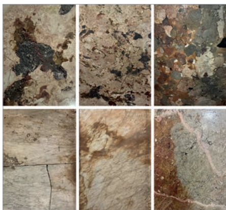
Рис. 1. Характерные виды дефектов поверхности камня: трещины, отбитости, выщербины, неудачные докомпоновки
