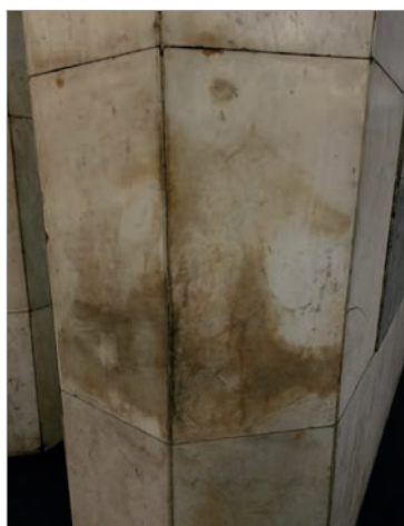
Рис. 3. Ржаво-рыжие пятна, не поддающиеся удалению на пилоне станции «Охотный Ряд»
